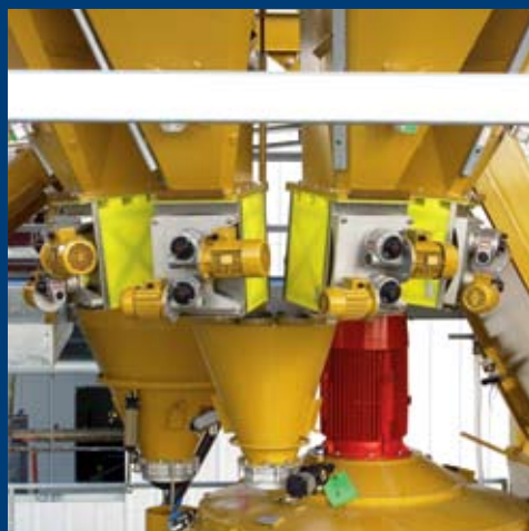
Tørfarvevægt med indløb fra fire doseringsnegle.
