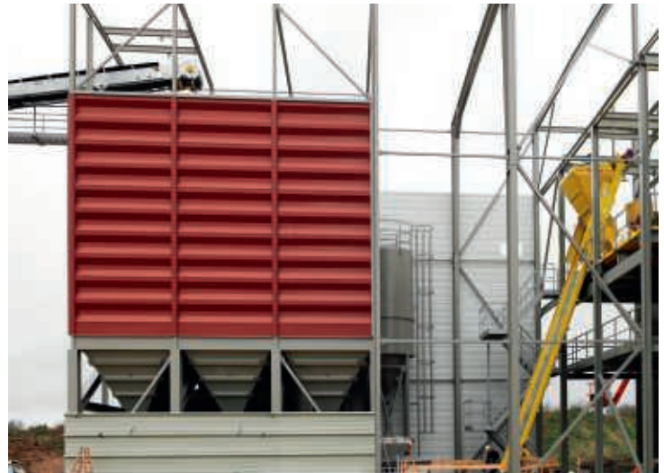
Hochsiloanlage mit Einfüllsystem.
