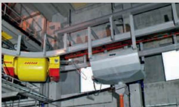
Spülstation zur Reinigung eines 2000 Liter Duo-speed Kübelwagens.
