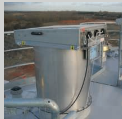
Staubfilter oben auf dem Silo.
