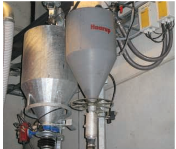
Slurryfarbwaage und Wasserwaage mit Ein- und Auslaufventilen.
