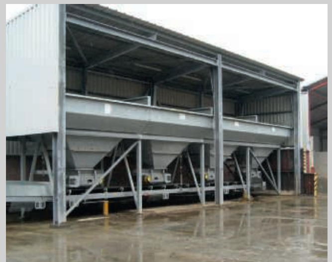
Tagesilos zum Befüllen mit Radlader.
