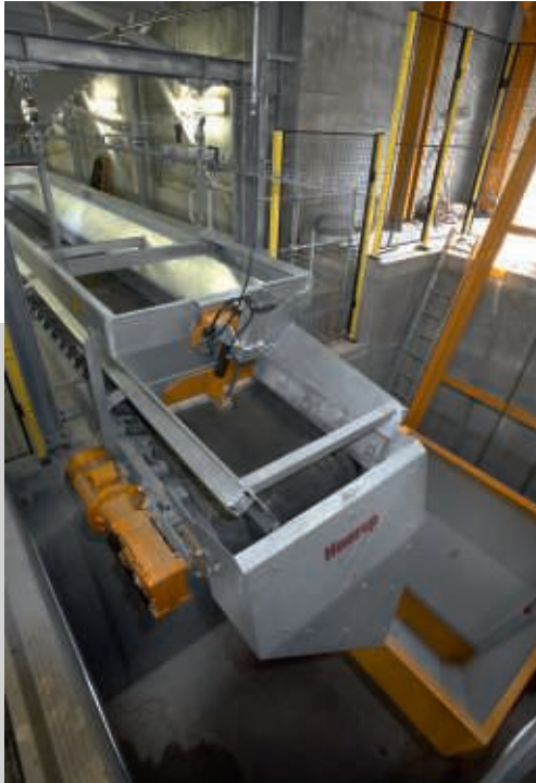
Wiegeband mit Schrägtrichter für einen Aufzug.
