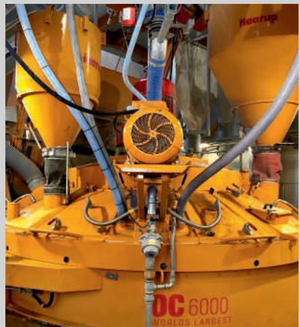
Druckerhöhungspumpe für die Zwischenreinigung des Mixers.
